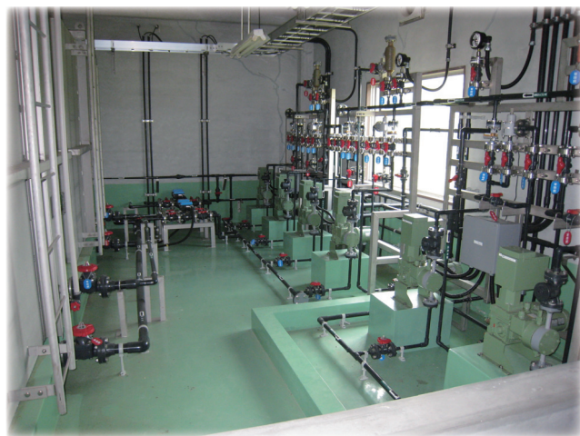
薬液注入施設
