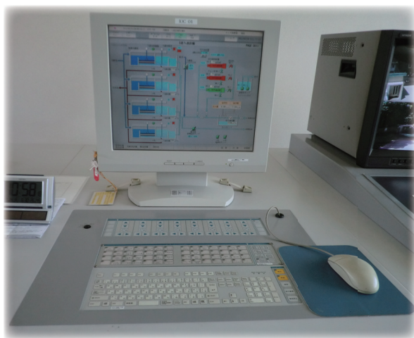
林浄水場中央制御システム
