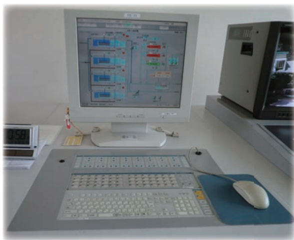
林浄水場中央制御システム
