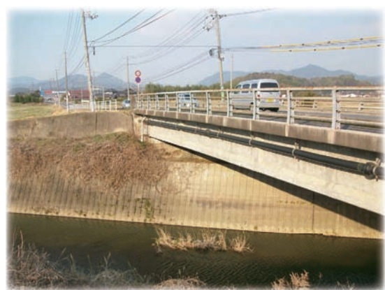
市内橋梁添架管
