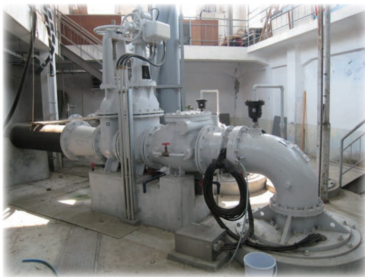
▲取水ポンプ（第2取水）
