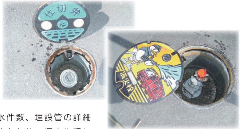
▲配水管に設置している 仕切弁（左）、消火栓（右）
