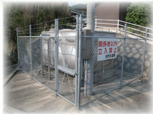
▲高台給水のための加圧施設（西ノ庄）
