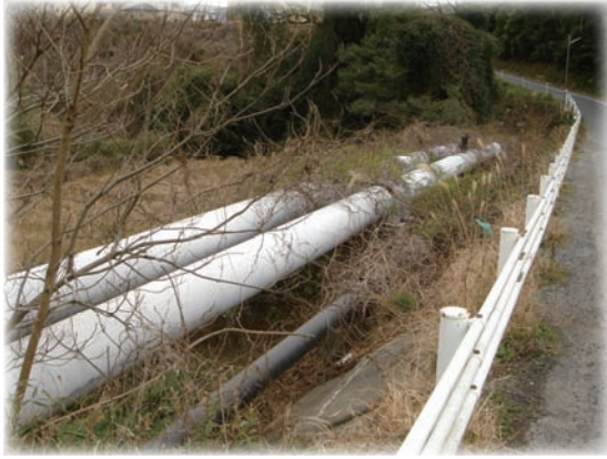
▲林浄水場から清山配水池へ連絡する送水管
