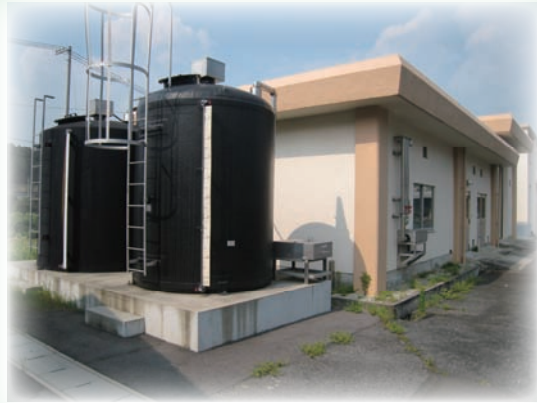
▲薬品注入棟と硫酸バンド貯蔵タンク
