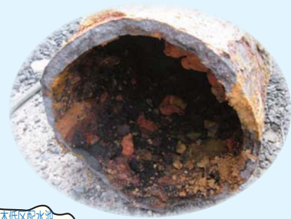
▲ 老朽化した水道管の内部
