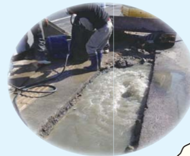
← 水道管破裂による漏水
