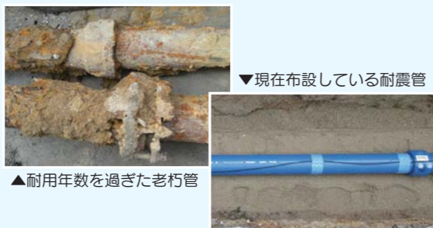
市内約31.4%の水道管は耐用年数を過ぎています。(平成25年度末現在)
